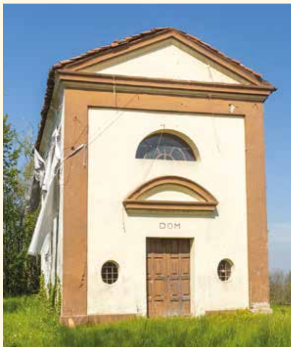
La facciata della chiesa. Sono visibili brandelli del telo con cui è stato coperto il tetto per evitare infiltrazioni di acque piovane
